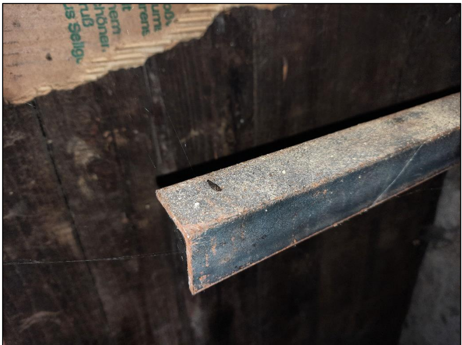
Foto 9: In der Scheune konnten schon bei der Erstbegehung einzelne Kotballen von Fledermäusen gefunden werden.
